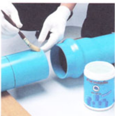
7. ทาน้ำยาหล่อลื่น Pipe Lube บริเวณด้านในหัวท่อและปลายท่อ
