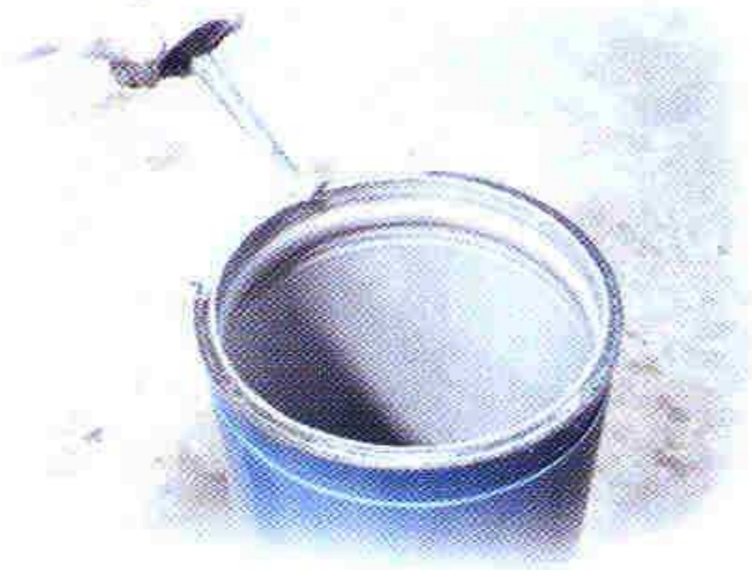
2.1 ทากาวเฮอริเมตชีต 55 ที่หน้าตัดท่อเพื่อป้องกันสนิมบริเวณหน้าตัดท่อ
